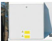
9 Zentrale Aufbauelektronik innerhalb eines wasserdichten Kastens. Leichter Zugang.
